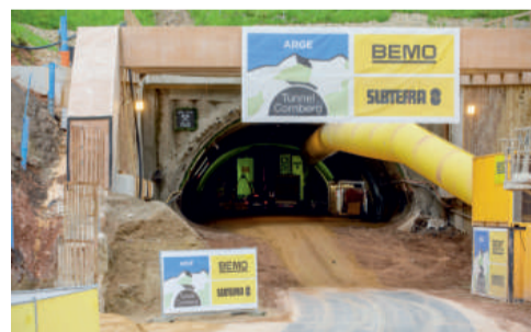
V květnu již byly vyraženy první desítky metrů tubusu, ceremoniál tedy probíhal v tunelu.
