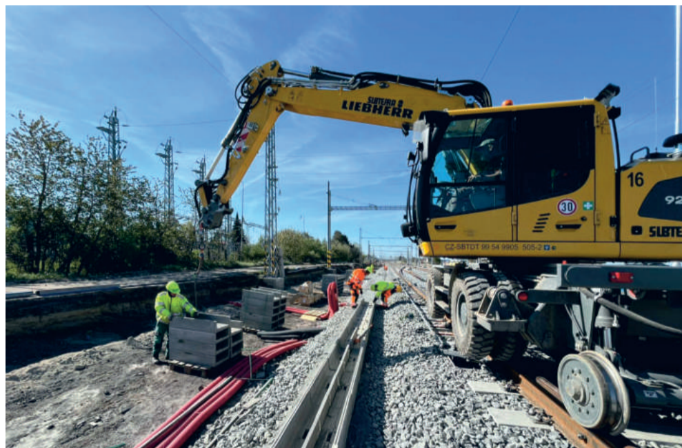
Vedle samotných kolejí pracuje divize 3 na souvisejících technologických objektech, ke kterým patří odvodnění a kabelové chráničkové trasy.
