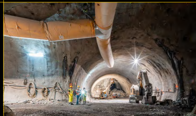
RAŽBA VERTIKÁLNĚ ČLENĚNÉ KALOTY OBRATOVÉHO TUNELU 07/2023 EXCAVATION OF VERTICALLY DIVIDED TOP HEADING – THE TUNNEL FOR TURN-BACK TRACKS 07/2023
