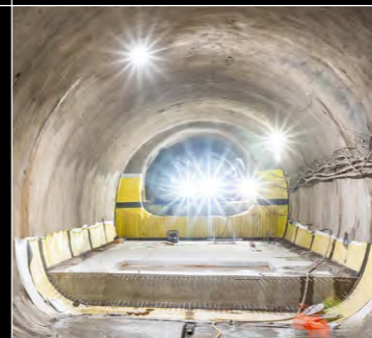
REALIZACE HYDROIZOLACE A SEKUNDÁRNÍHO OSTĚNÍ DNA TECHNOLOGICKÉHO BLOKU SEVER – 09/2024 CONSTRUCTION OF WATERPROOFING AND SECONDARY LINING OF THE BOTTOM – TECHNOLOGICAL TUNNEL NORTH – 09/2024
