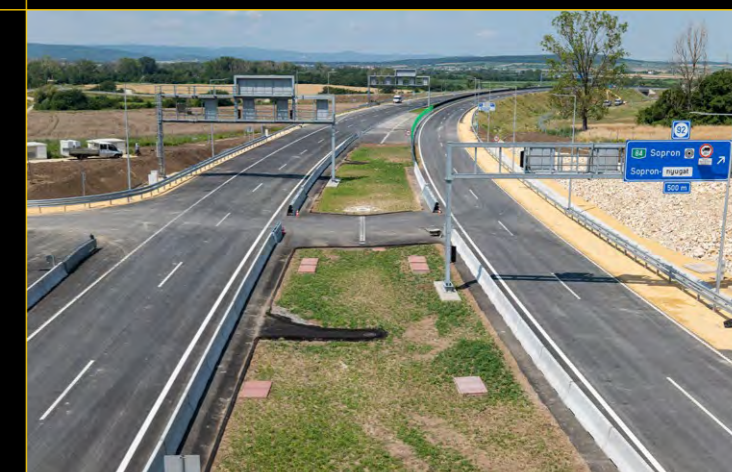
VÝSTAVBA SILNICE M85, 5. ETAPA FERTŐRÁKOS - SOPRON ZÁPAD CONSTRUCTION OF THE M85 ROAD, STAGE 5, FERTŐRÁKOS - SOPRON WEST
