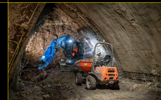
STROJNÍ RAŽBA KALOTY LEVÉHO DÍLČÍHO VÝRUBU STANICE PANKRÁC D MACHINE EXCAVATION OF TOP HEADING - LEFT SIDE DRIFT OF STATION PANKRÁC D
