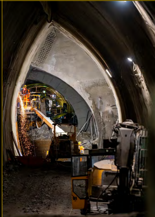
PRÁCE NA PRIMÁRNÍM OSTĚNÍ OPĚŘÍ LEVÉHO DÍLČÍHO VÝRUBU STANICE PANKRÁC D WORKS ON THE PRIMARY LINING OF THE LEFT BENCH PARTIAL EXCAVATION OF PANKRÁC D STATION
