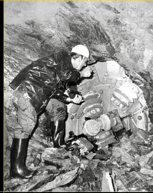
1970 OBLASTNÍ VODOVOD PŘÍSEČNICE 1970 PŘÍSEČNICE REGIONAL WATER SUPPLY SYSTEM
