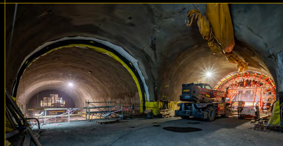
REALIZACE HYDROIZOLACE A SEKUNDÁRNÍHO OSTĚNÍ KLENBY - TECHNOLOGICKÝ BLOK SEVER A VZDUCHOTECHNICKÁ PROPOJKA CONSTRUCTION OF VAULT WATERPROOFING AND SECONDARY LINING - TECHNOLOGICAL TUNNEL NORTH AND VENTILATION GALLERY
