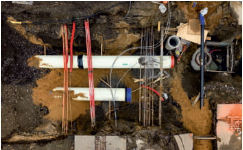
S trasou přivaděče se protíná mnoho dalších potrubí a kabelů.
