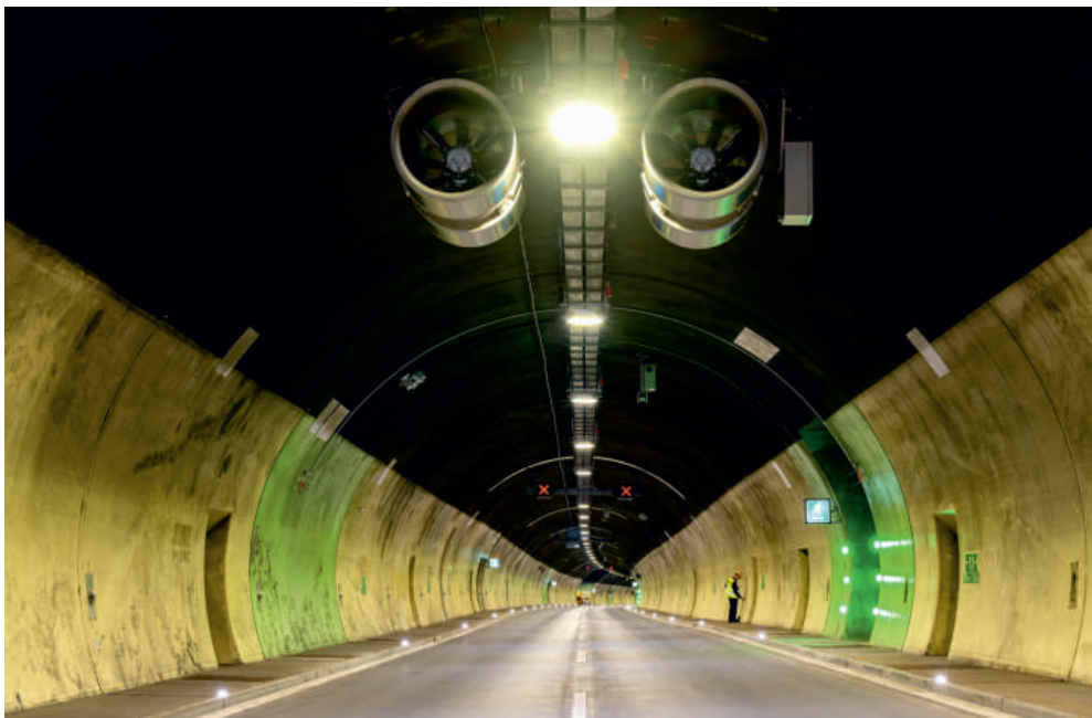
V běžném provozu i v havarijních situacích je pro bezpečnost dálničních tunelů vedle několika druhů osvětlení zásadní také větrání, které zajistí ventilátory španělské značky Zitron.
