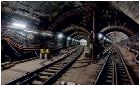
Projekt přináší nová svítidla a elektrorozvody ve třech mezistaničních úsecích.
