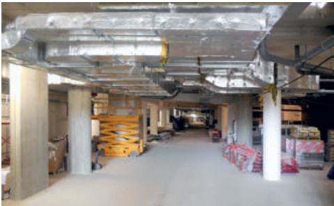
Divize 4 se podílí na většině mechanických profesí, například na vzduchotechnice.
