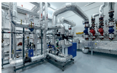
Zajištění vyhovujícího klimatu pro skladování knih vyžaduje množství technologií.
