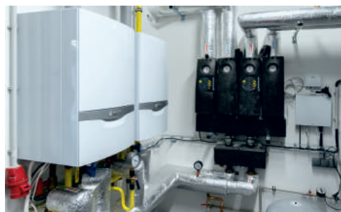
Vytápění i přípravu teplé vody pro osmnáct bytů zabezpečují dva plynové kondenzační kotle.
