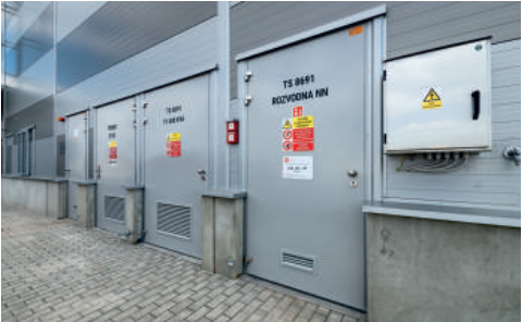
Kromě vzduchotechniky zajišťovala divize 4 také elektroinstalace.
