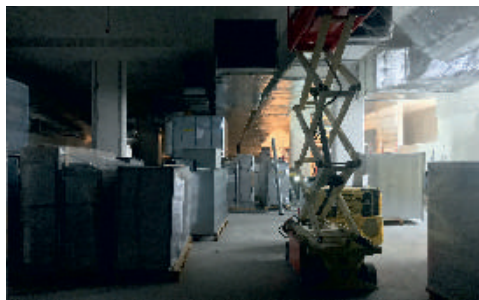
K systémům, na jejichž instalaci se podílí divize 4, patří také vzduchotechnika.
