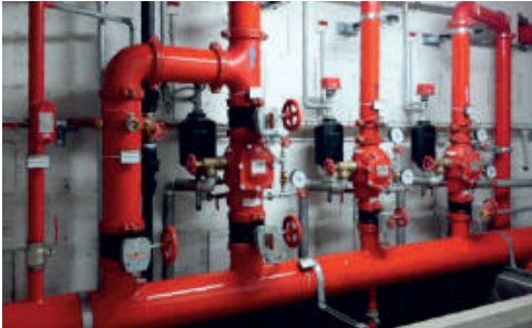
Hlavní strojovna stabilního hasičského zařízení budovy Mechanika 1 se nachází v 2. suterénu.
