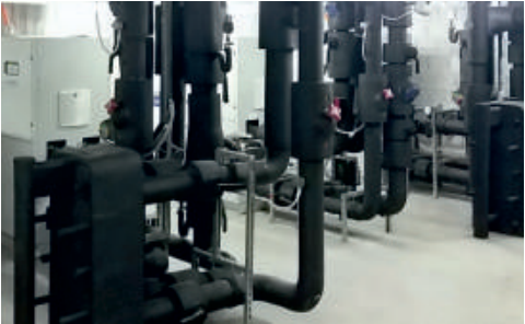
Podobné prostorové nároky má systém chlazení, jež rovněž dodávala divize 4.
