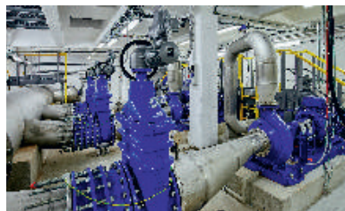
ČERPAČÍ STANICE HRDLŮŽEZY
