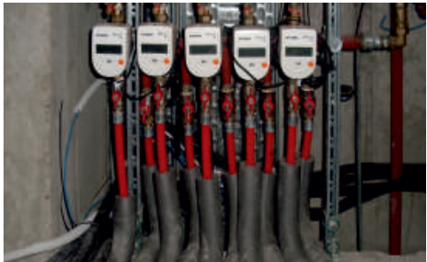
Sběrače a rozdělovače vytápění pro jednotlivé byty na patrech jsou již osazený.
