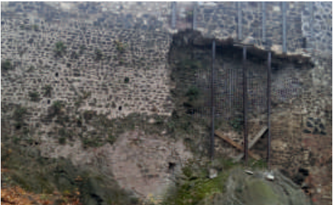
První výpadky zdiva z roku 2012 byly provizorně zajištěny nosníky, táhly a sítí.
