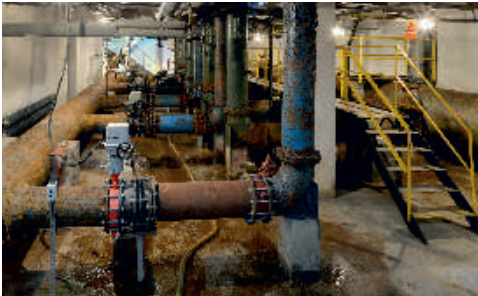
Rekonstrukce objektu je nezbytná, což dokládá i pohled do jeho suterénu.
