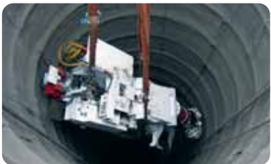
ALPINE RAZÍ KABELOVÝ TUNEL
